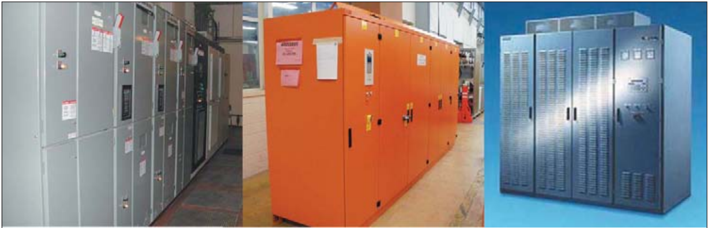
Рис. 16. Общий вид конструкции высоковольтных ПЧ различных типов
